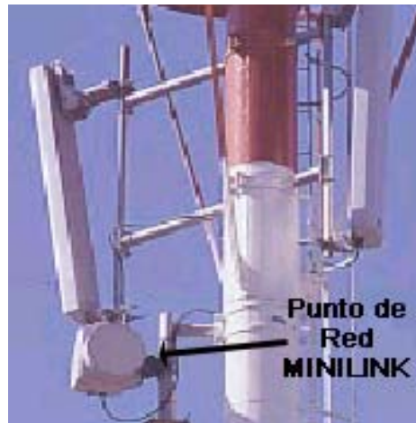
Figura 4.2. Equipamiento outdoor MINILINK.
